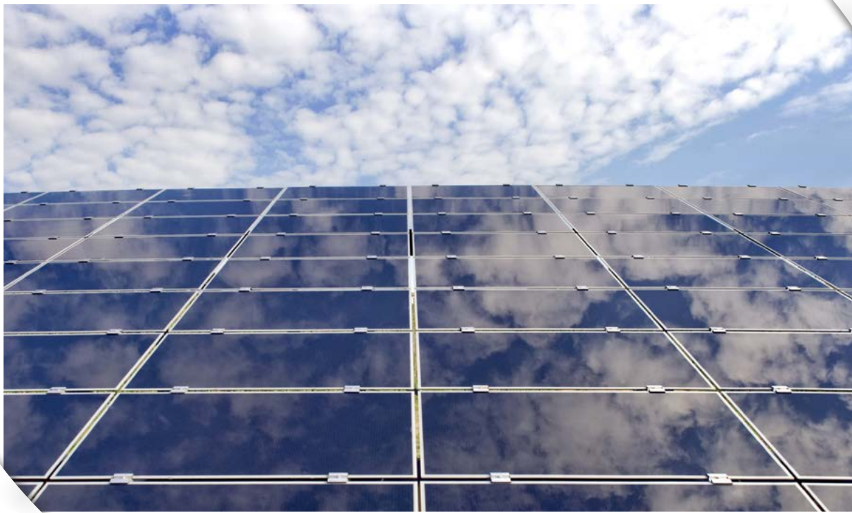
Centrale solaire photovoltaïque dans la banlieue de Narbonne
