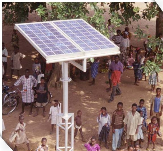
Captteur solaire installé en haut d'un mât dans le village de Towé au Bénin
